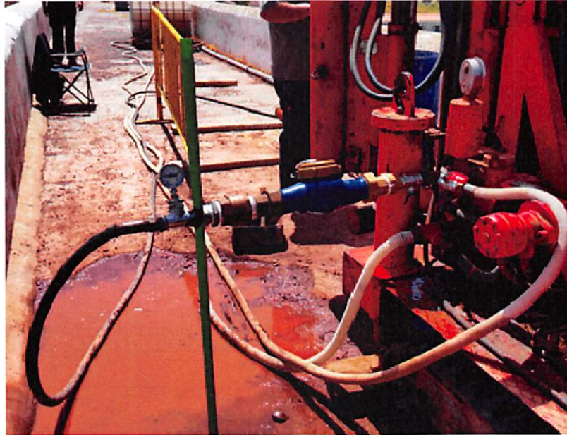
Figura 20. Imagen manómetro y caudalímetro empleado en la ejecución del ensayo.
